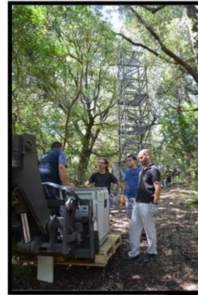
Fasi dell'installazione di un PTR-MS
